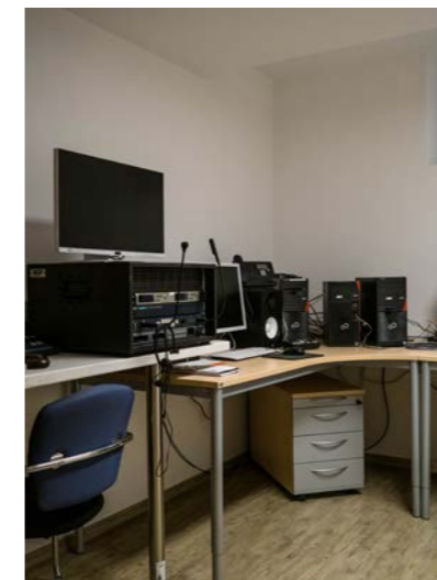
Technikraum in Zwiesel
