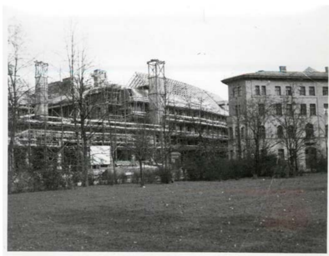
Dienststelle München: Blick auf die Baustelle vom gegenüberliegenden Alten Botanischen Garten (Ende 1938)
