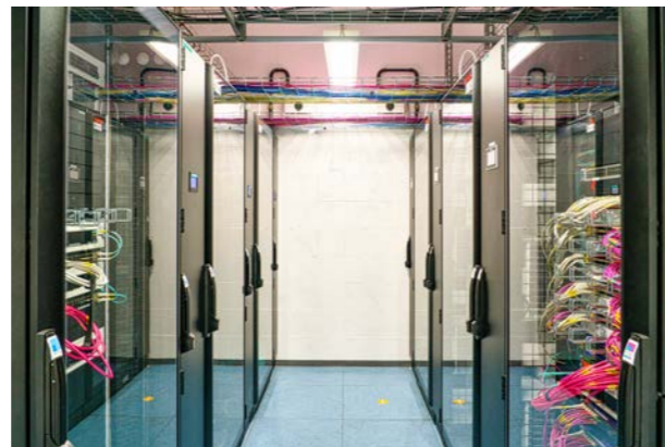
Serverschränke im RZ-Nord
